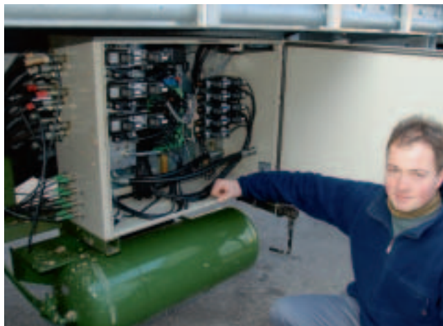
Beat Keller vor dem auf dem Anhänger montierten Steuerungskasten.
